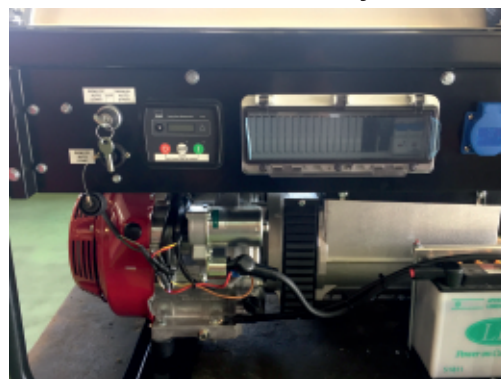
Instalace v rámu elektrocentrály
