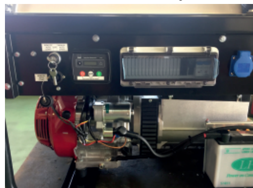
Instalace v rámu elektrocentrály
